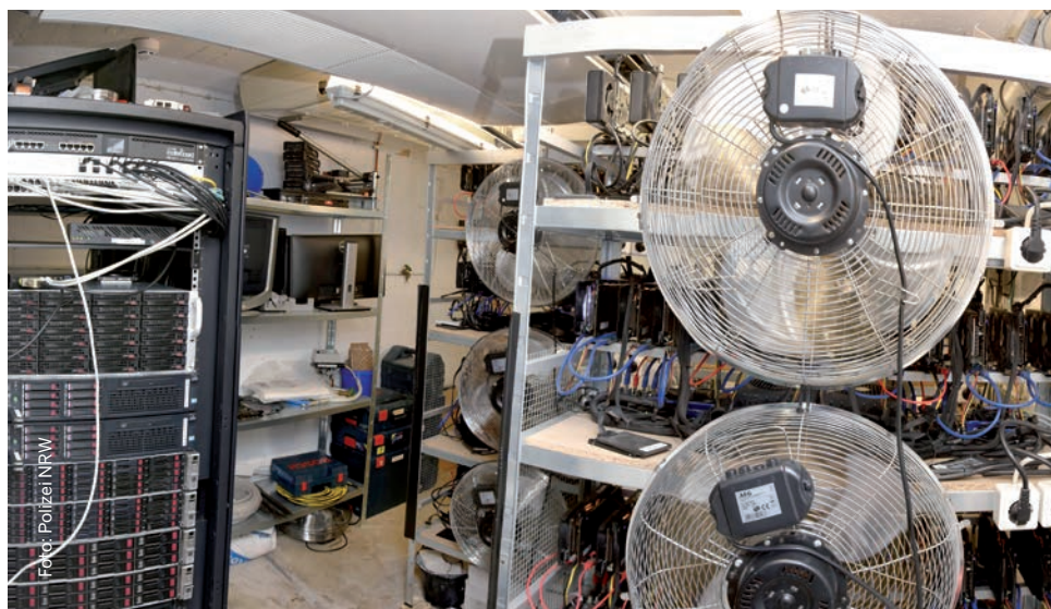
Der klimatisierte Serverraum im Keller.
